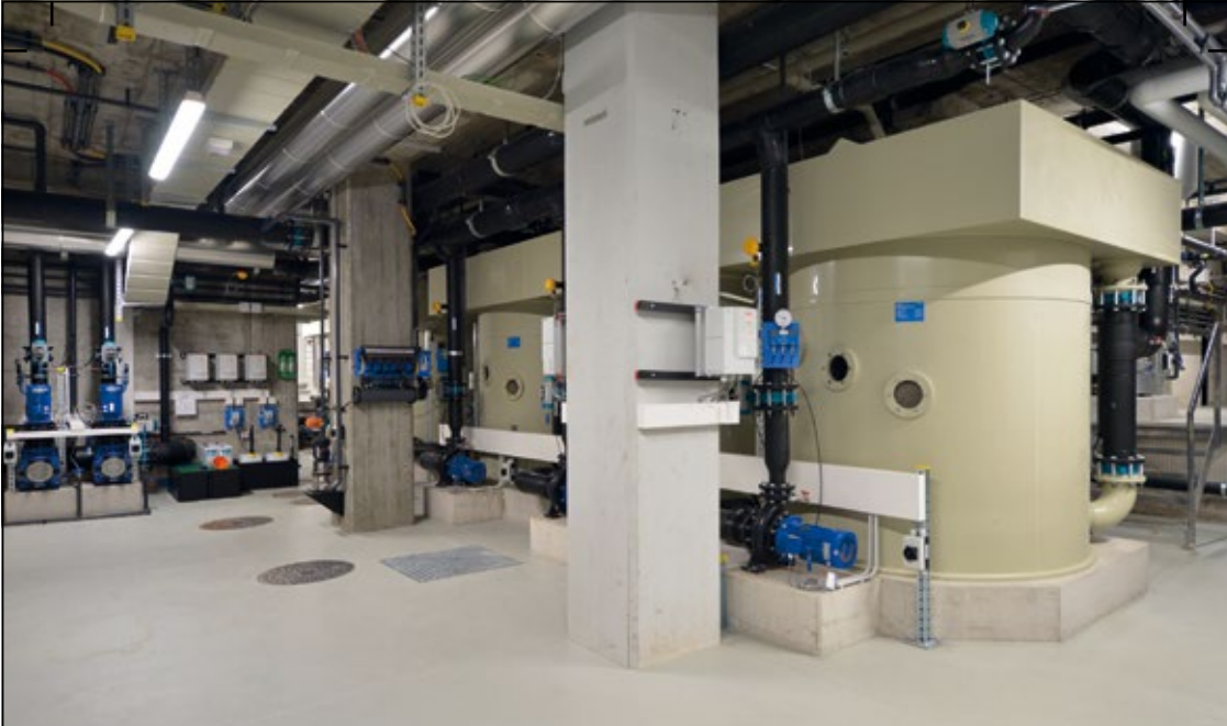
Freizeitbad Opfikon, Unterdruckfilter, Q 380 m 3 /h
