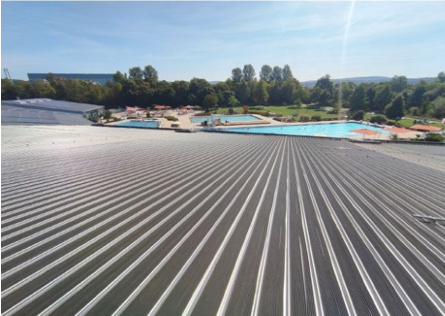
Die Kraft der Sonne als Wärmequelle nutzen: eine Absorber-Anlage.
