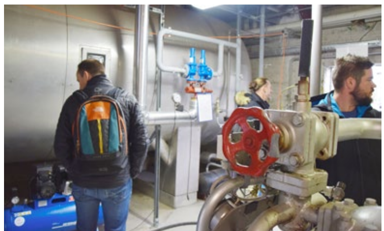
In der überarbeiteten Technikzentrale.
