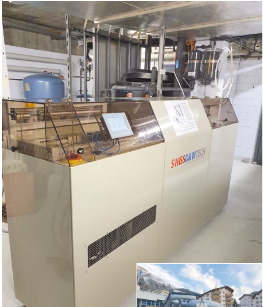
Foto oben: Nachhaltige Modernisierung von Elektrolyseanlagen.
