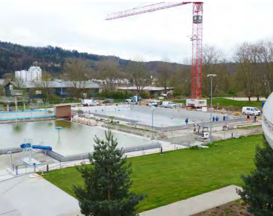
Übergang von der 1. zur 2. Bauetappe mit Vorbereitungen zum Einbau des Edelstahlbeckens in die 50-Meter-Schwimmanlage und die Sanierungen an der Sprunganlage.
