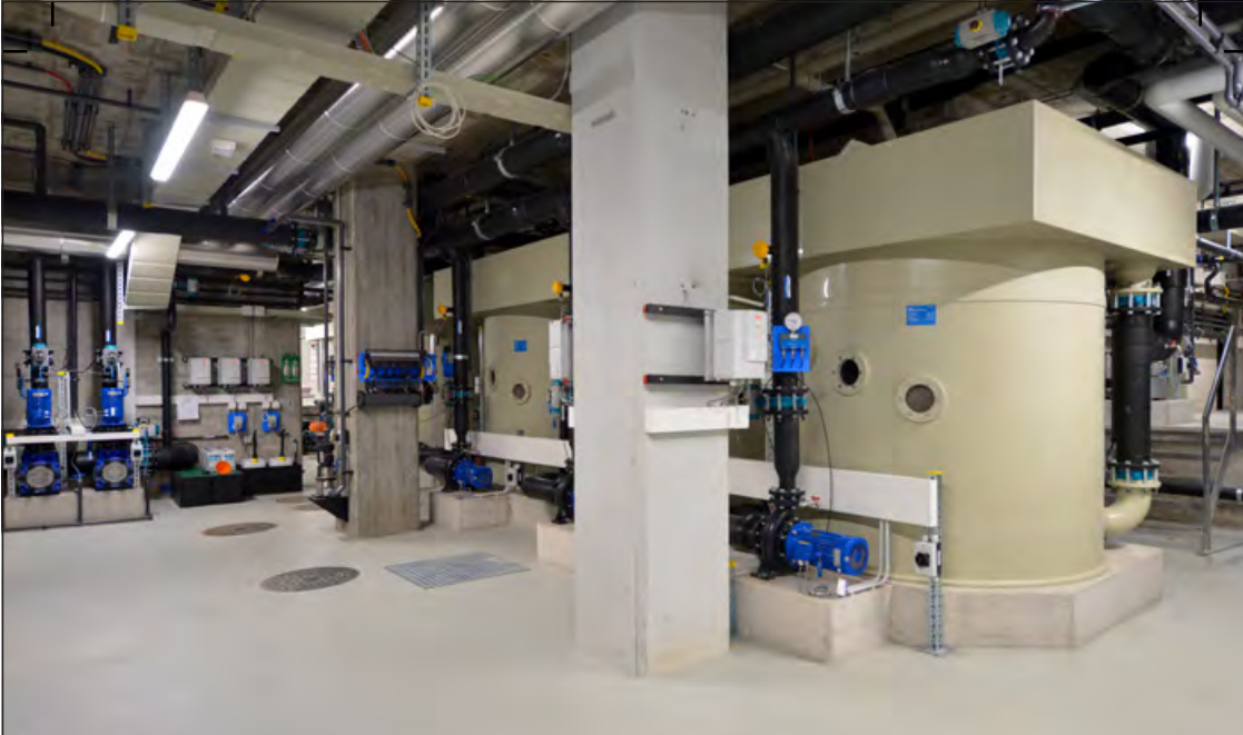
Freizeitbad Opfikon, Unterdruckfilter, Q 380 m 3 /h
